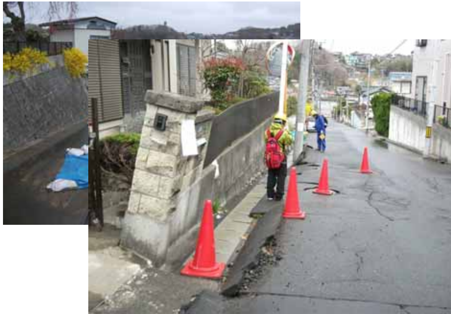
地すべり性の動き 太白区緑ヶ丘4丁目
