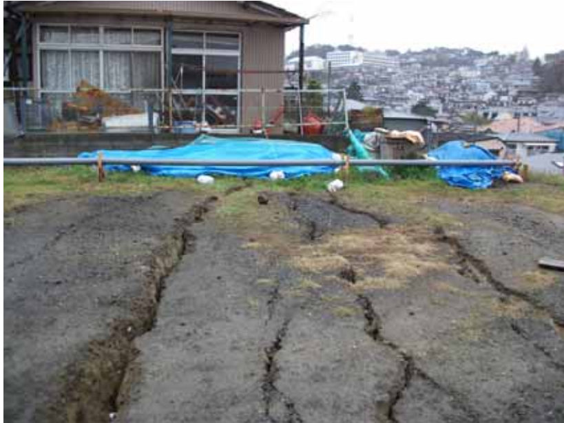
地すべり発生個所近傍斜面でのキレツの発生(青山2丁目) 変動監視の必要性 = 市内に多数
