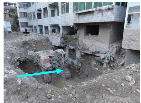
写真-6 三眼峪沟 ビルの破損
