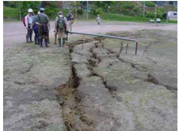
写真-13 山古志中学校グラウンドの段差 (平成 17 年 5 月 23 日撮影)
