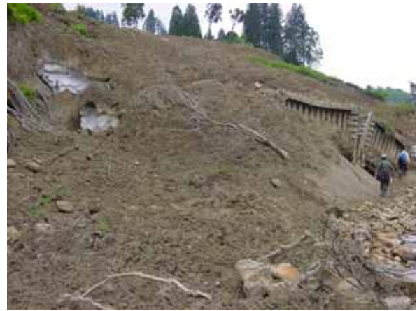
写真-8 末端部の状況 (土砂雪崩が芋川まで達した。)
