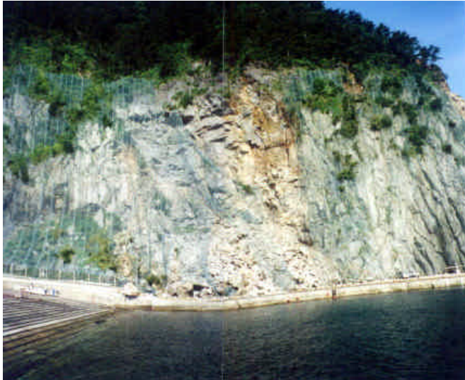
写真-2 流理や節理が発達する流紋岩体の急崖の崩落（渡浮根漁港）。
