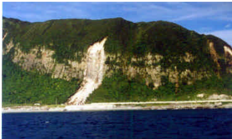
写真-6 溶岩円頂丘遷急線直下の崩壊（赤崎峰の西側斜面）。崩壊は火砕部のみを生じており、下位にある溶岩の崖では表層の植生が削り取られたのみ。
