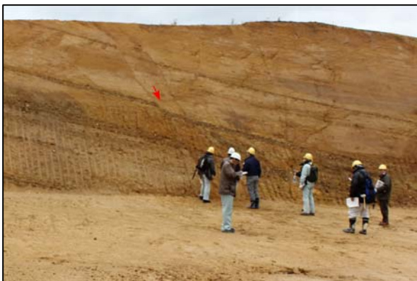
写真 4 上釜戸地すべりの頭部の切土面に現れた正断層
