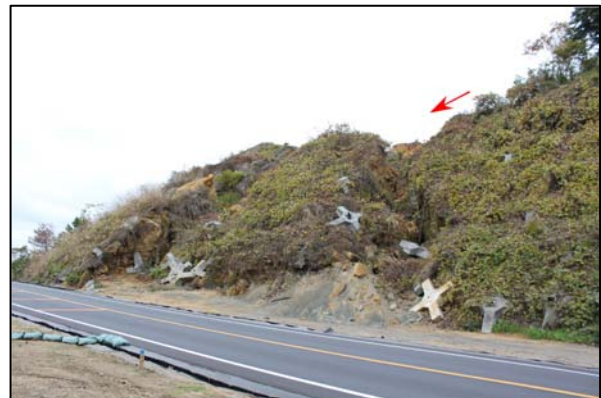
写真 5 上釜戸地すべりの末端部の変状
