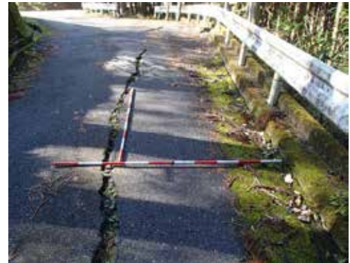
写真-3 町道の地すべり変状
