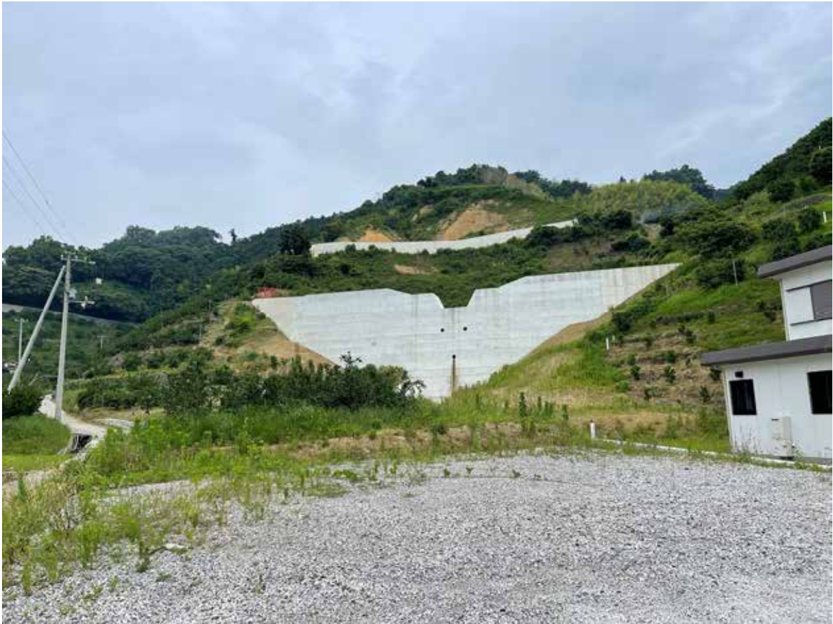
写真－３：愛媛県宇和島市吉田町畦屋の崩壊地。
