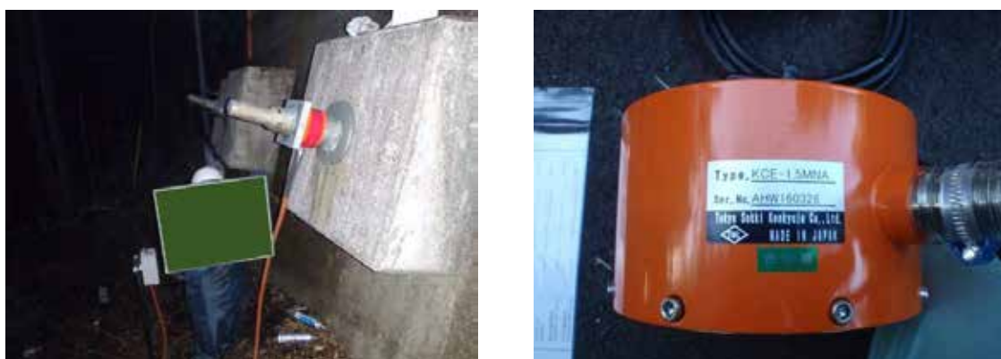
写真-1 調査地に設置したアンカー荷重計と設置状況
