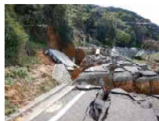
② 上部市道は完全に破壊 (開口亀裂に囲まれたブロックに分離) 約15m下方に移動している
