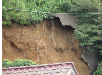
モルタル吹付の崩壊状況
