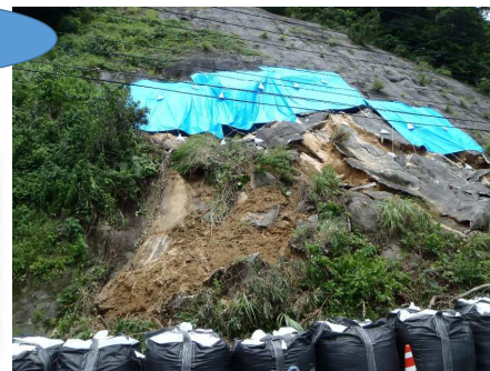
モルタル吹付斜面の崩壊
