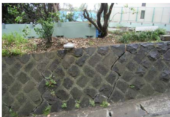
図 17 盛土擁壁に見られる変状
