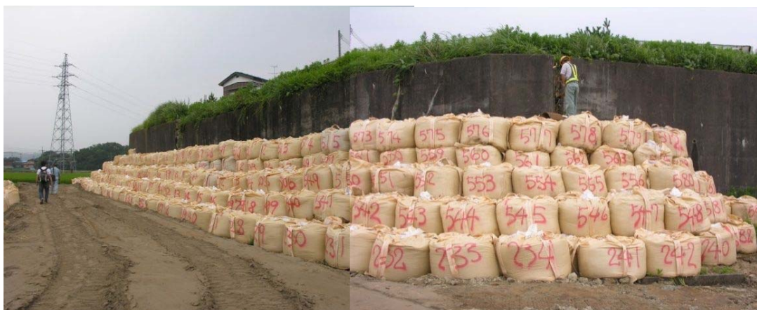
図 - 19 上田尻地区の宅地擁壁倒壊現場と押さえ土嚢(トンパック)。
