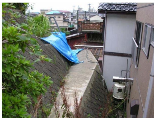
図— 1 5 番神地区における地盤変動に伴うコンクリート擁壁内のクラック (図 13 中の P2)。この周辺が最も家屋の被害も甚大であった。
