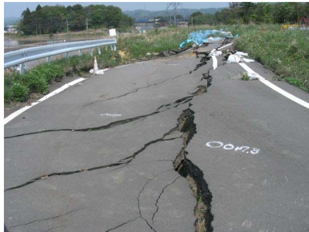
図 - 2 0 上田尻地区の倒壊擁壁上部の市道内のクラック .
